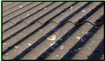
Eural 170605 asbesthoudend bouwmetaal
